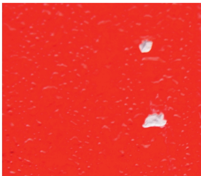
In den weniger beanspruchten Bereichen kommt es zur Blasenbildung, darunter ist die Weißrostbildung erkennbar. Quelle (zwei Fotos): DFO
