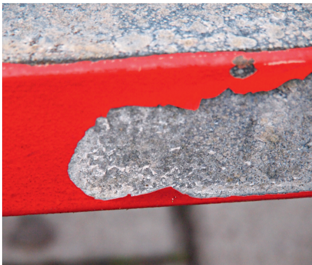
Die verzinkten Profile sind mit einem roten Pulverlack beschichtet. Hier ist das Fehlerbild stark ausgeprägt. Der Lack löst sich großflächig ab, darunter hat sich Weißrost gebildet.
