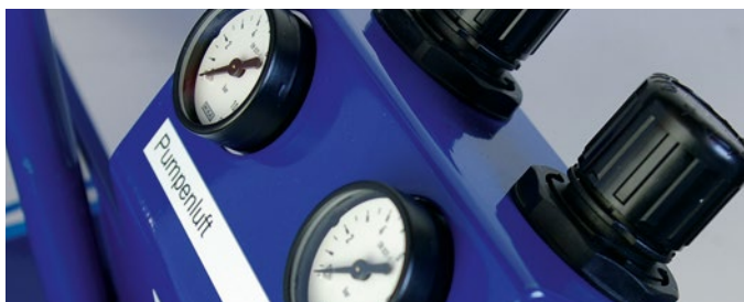
Die Schalttafel ist mit ein oder zwei Reglern ausgestattet. Quelle: Dete
