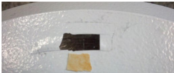
Bild 3: Die Beschichtung des Stahlbauteiles ließ sich durch Einschneiden der Lackschicht leicht ablösen.
