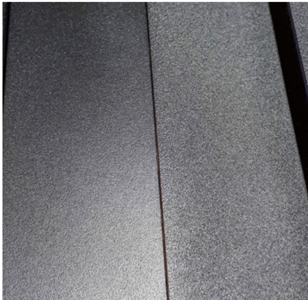
Die Strukturunterschiede sind mit dem bloßen Auge zu erkennen. Abweichungen der Schichtdicke können zu solchen Effekten führen.
