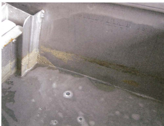
Bild 1 > Biologische Ablagerungen im Passivierungsbecken der Vorbehandlungsanlage.
