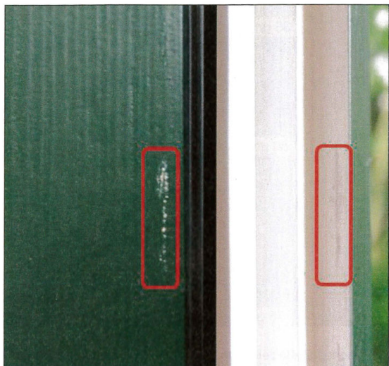
Bild 4 > Eine unzureichende Blockfestigkeit verursachte Abplatzungen an den Kanten eines eingebauten Holzfensters.
