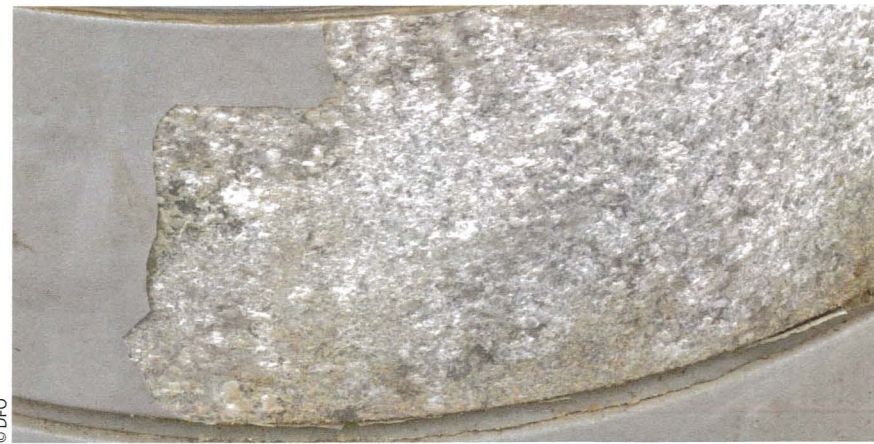
Bild 4 > Bereich der abgeplatzten Beschichtung.
