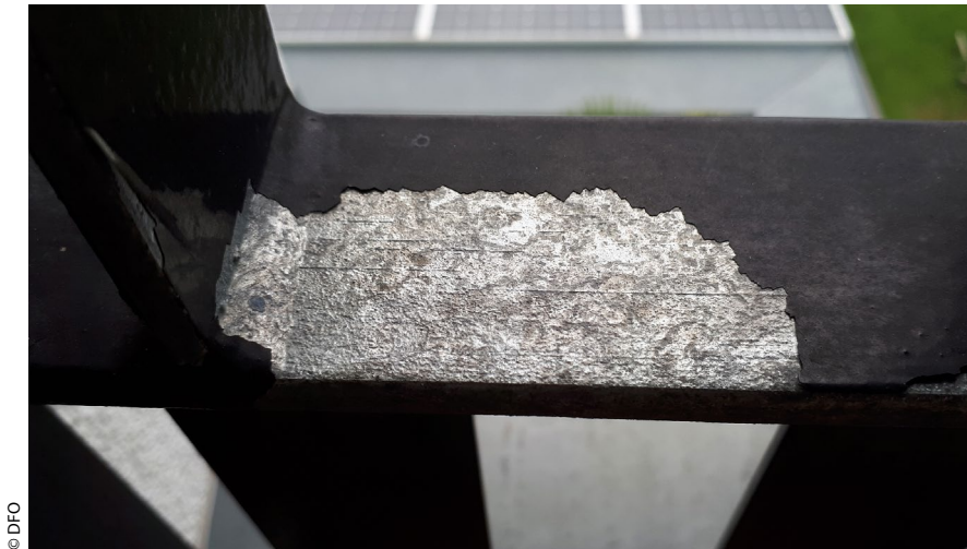
Bild 3 > Feuerverzinktes Substrat mit abgeplatzter Beschichtung: Die Beschichtung des Balkongeländers hat sich rückstandsfrei vom Untergrund gelöst.
