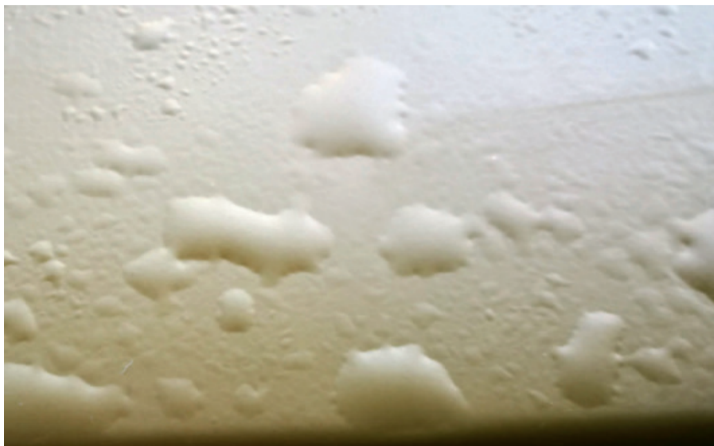
Die Delamination trat zwischen Grundierung und Decklack auf.
