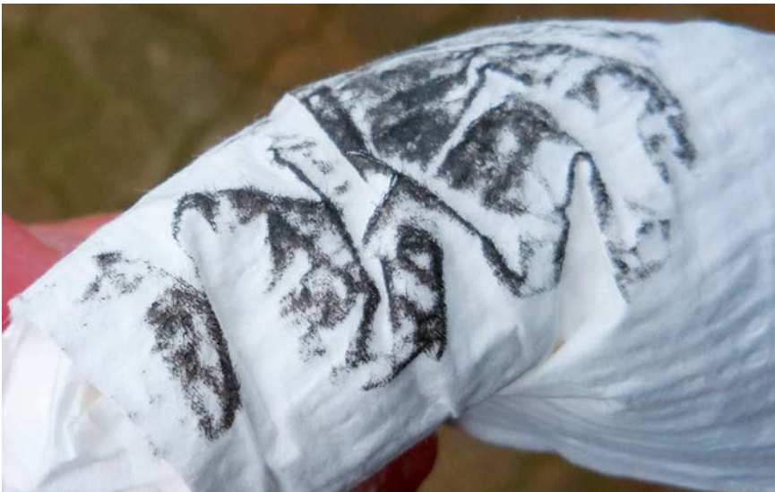
Bild 2 > Nach dem Abreiben der Bauteiloberfläche mit einem weißen Lappen zeigten sich schwarze Rückstände, bei denen es sich um Fette und Öle handelte.
